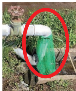
※2 給水栓に収穫ネットの取り付け例
