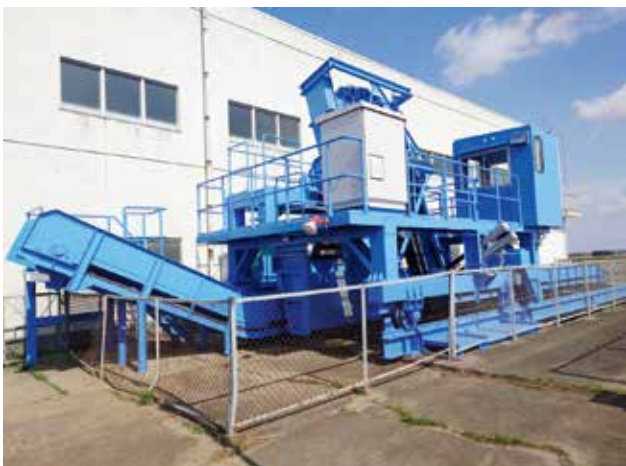
十角排水機場
